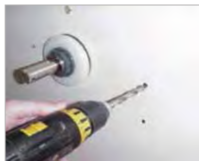
Gat boren \varnothing 11 . Minimaal 80 mm diep.
